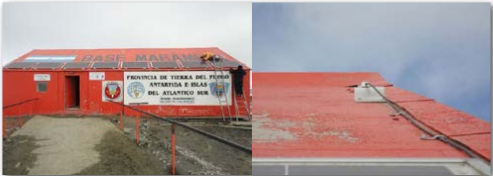
Figura 2 – Radiómetro fotovoltaico instalado en la Base Marambio, Antártida Argentina.
